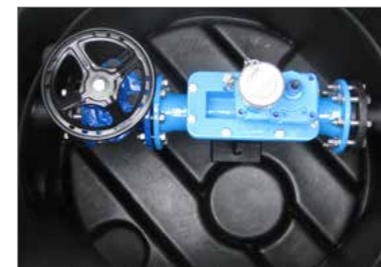
Schieber- und Putzschacht
