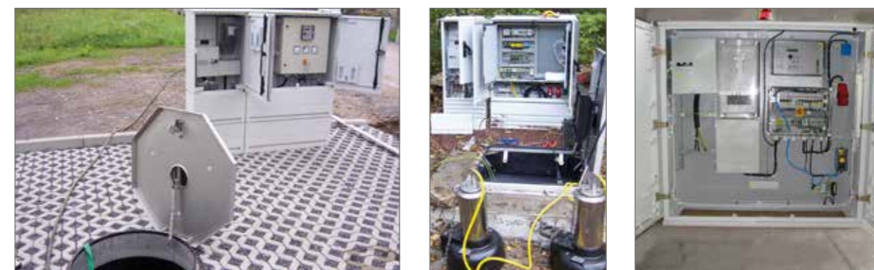
ROMOLD kundenspezifische Schaltanlagen
